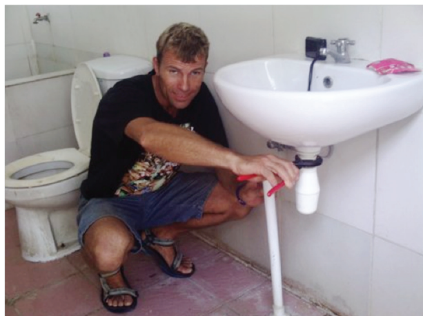
Her er jeg ved at reparere afløbet under en håndvask på hjemmet Ahi Sauns.
