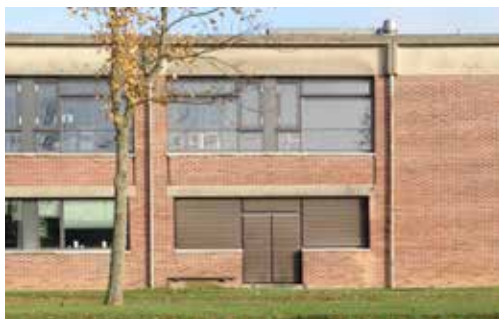
Figur 11.6. Dynamisk glasfacade på 1. sal i bygning 2 på Teknologisk Institut i Taastrup.
