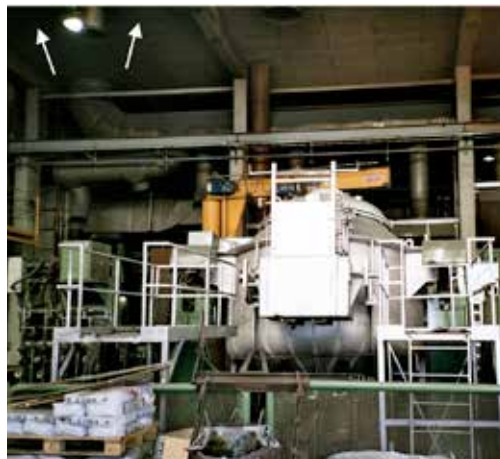
Figur 6.7. Simpel udsugning (tagventilatorer) fra en smelteovn markeret med pile.
